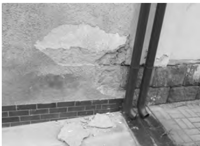
Poškození zdiva na KD
