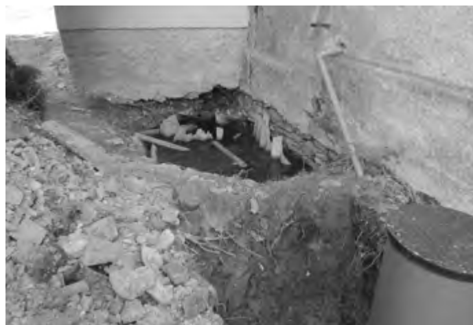
Kvůli nebezpečnému odpadu, který asi nejde vyndat, si budeme muset dodělat kanalizaci sami
